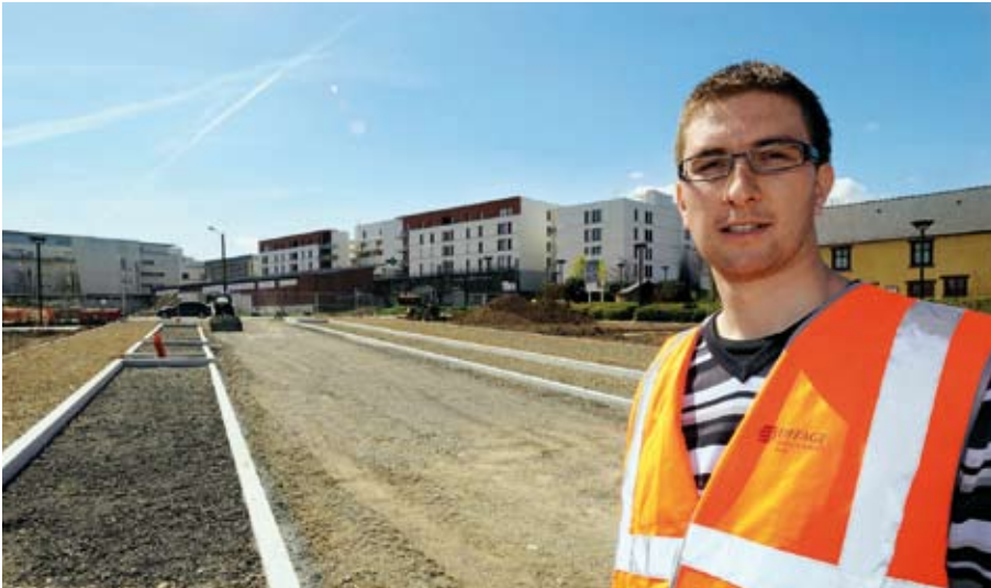
François Le Quernec, conducteur des travaux, devant le prolongement du cours Jean-Jaurès.
